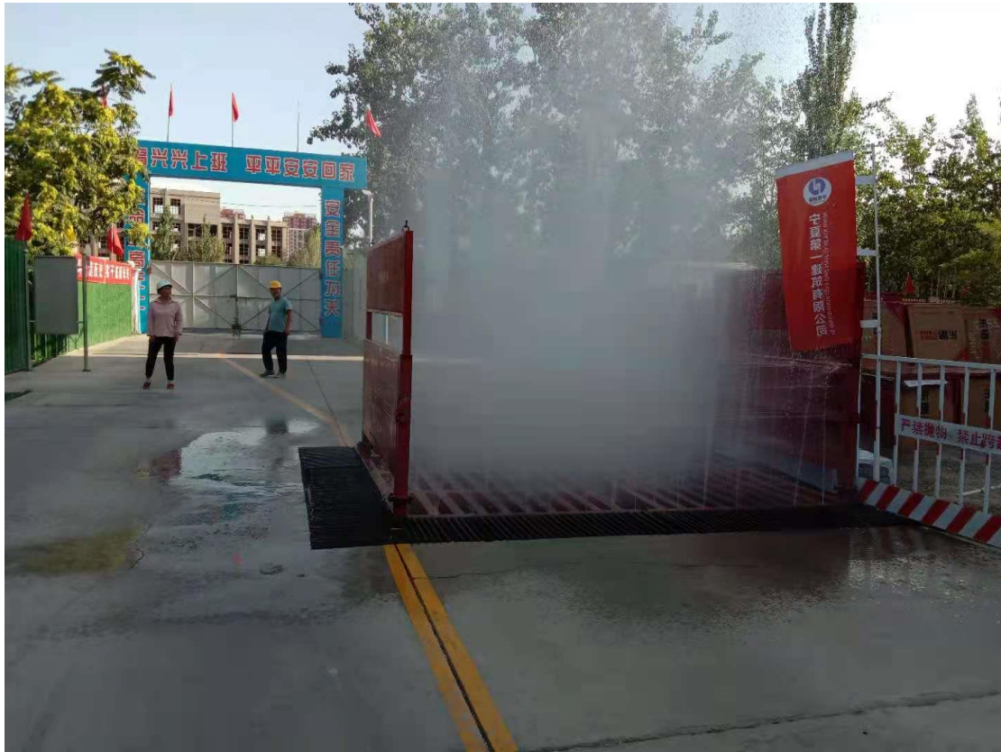
冲洗设备运行检查
