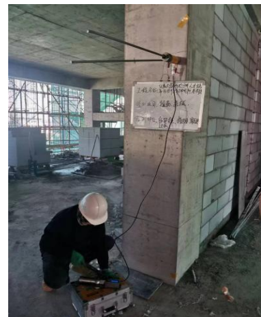
植筋拉拔及主体回弹试验
